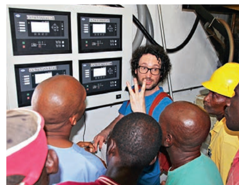
Dave Dunnet (Qinous) erklärt die Steuerung der Generatoren.
