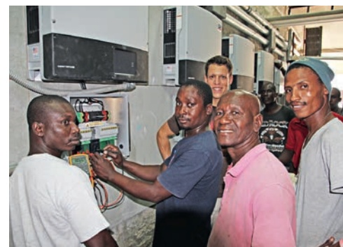
Kontrolle der Wechselrichter.
