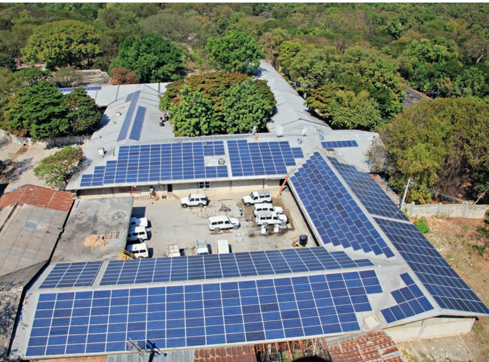
HAS mit 800 Solarpanels verkabelt, Januar 2015.
